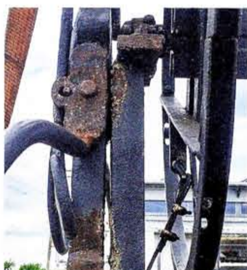
6 Sekundäre Veränderung des Schwungrads und dessen Lager: gebrochene Schweißung, Oberfläche ist partiell schon freigelegt.
